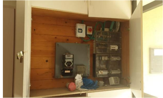
איור 13: ארון ראשי
