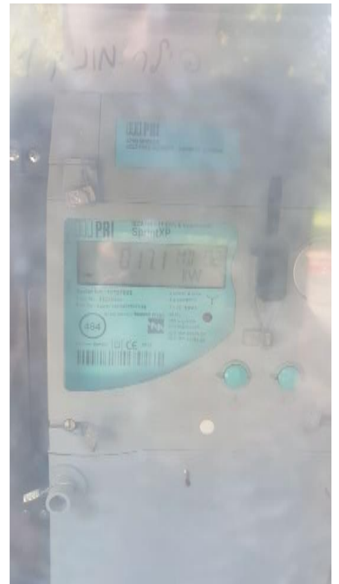
איור 9: מונה צריכה
