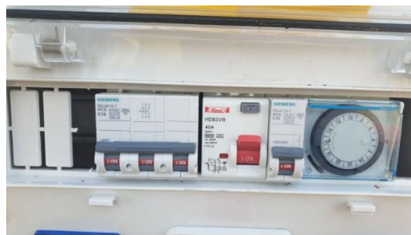
איור 7: מפסק ארון מגרש
