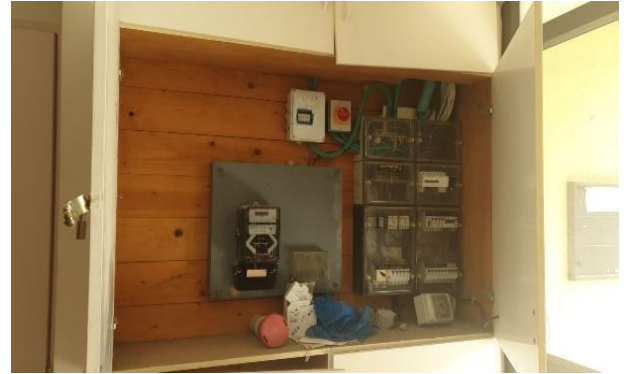
איור 13: ארון ראשי
