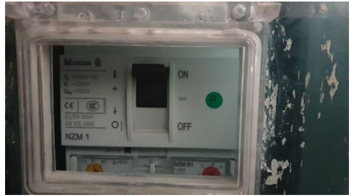
איור: סמפסק ראשי
