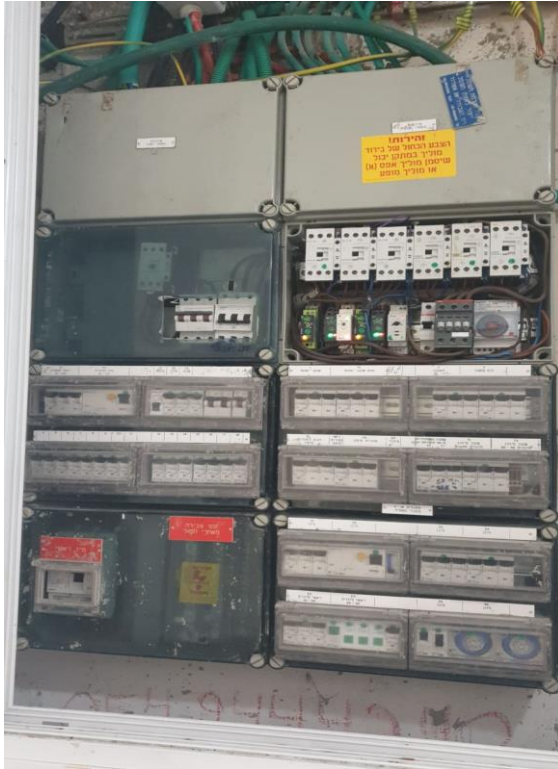
איור 10: ארון ראשי
